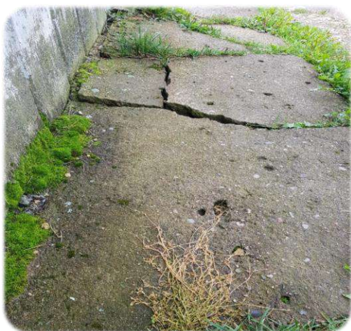
Рис.5. Разрушение отмостки здания
